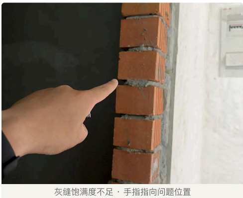
灰缝饱满度不足·手指指向问题位置
