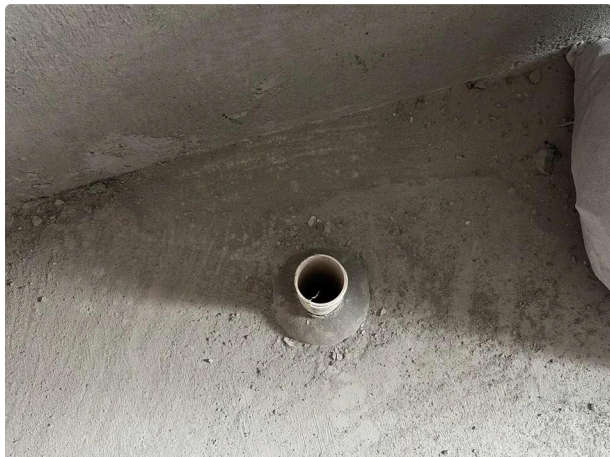
下水管口裸露
