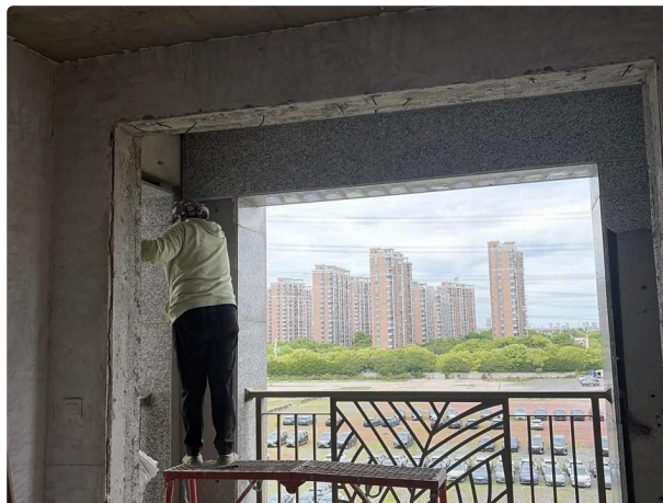
次卧阳台 · 无防护高处作业
