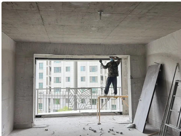
客厅阳台 · 无防护高处作业
